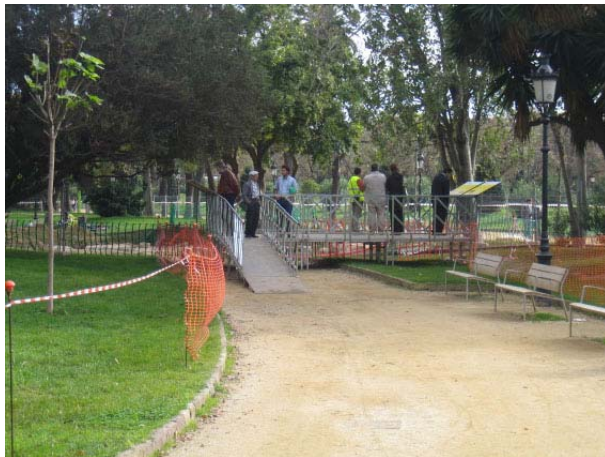
FOTO 62. Accés a la plataforma habilitada per tal que el públic pogués observar les tasques d'excavació i el jaciment
