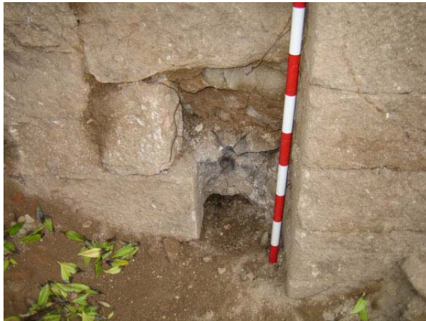
FOTO 60. Restes d'una perforació a l'interior del portal, interpretada com a possible barrina per a la voladura de les estructures durant les tasques d'enderroc de la Ciutadella
