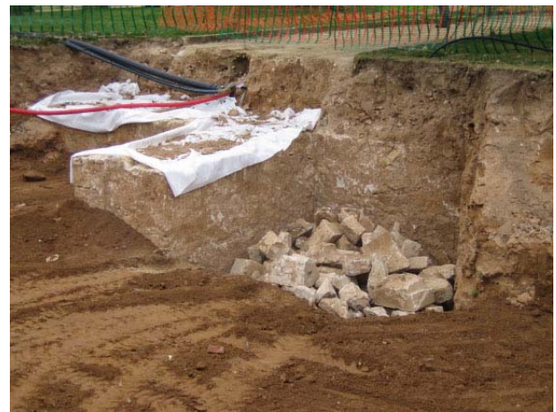
FOTO 67. Carreus recuperats durant la intervenció dipositats a tocar d'un dels contraforts del baluard de la Ciutadella (vegeu planimetria, annex 3)
